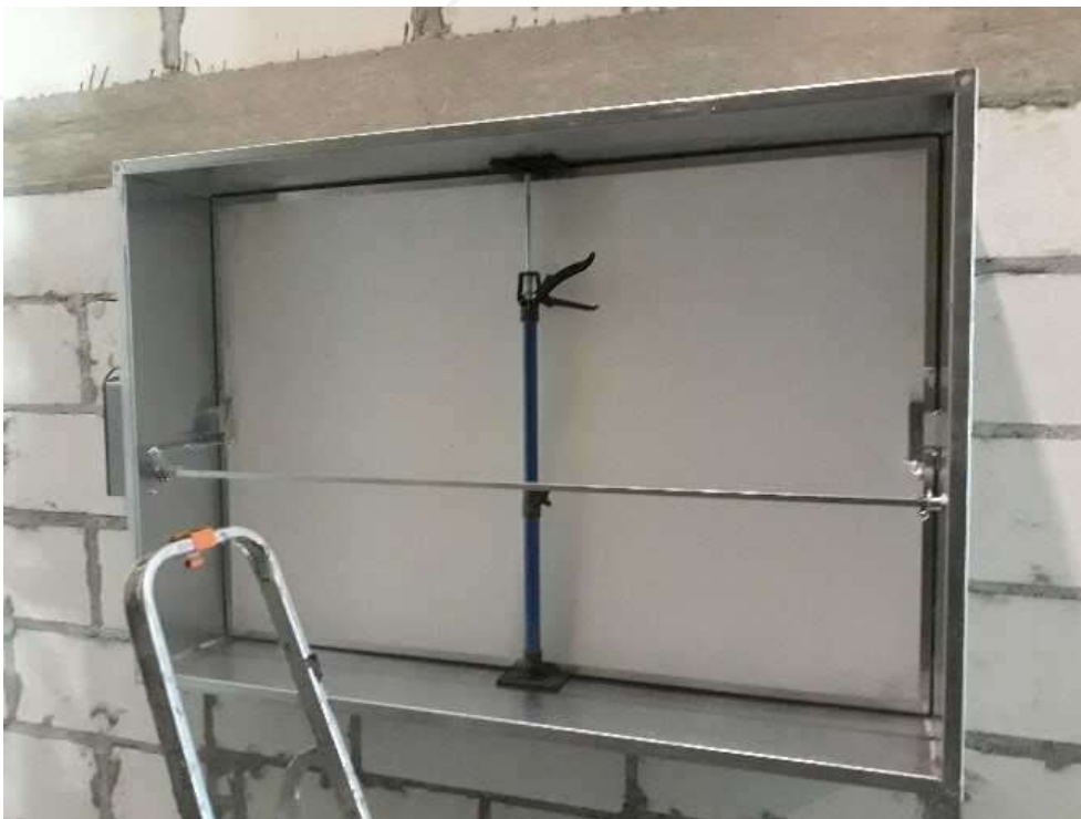
Rysunek 3. Prawidłowe przygotowanie klapy do zabudowy – zastosowanie rozpórki zabezpieczającej przed wgnieceniem korpusu klapy.
